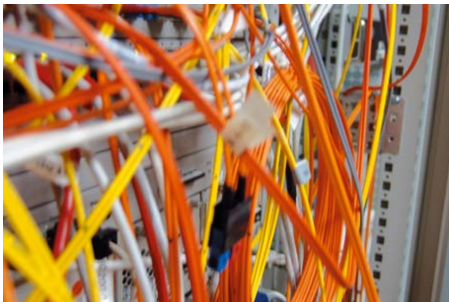
Optimal vernetzt: Das Rechenzentrum der Uni
